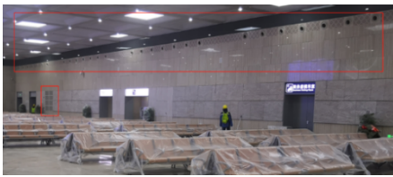
图 4 候车厅空调系统球形喷口及回风口
