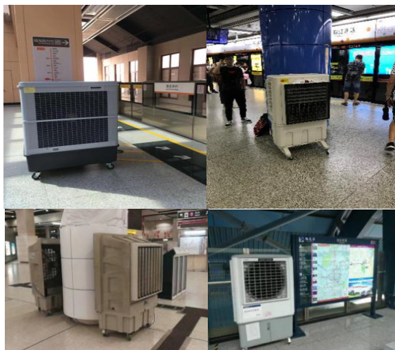
图 14 国内地铁站应用单元式直接蒸发冷却空调实际工程
