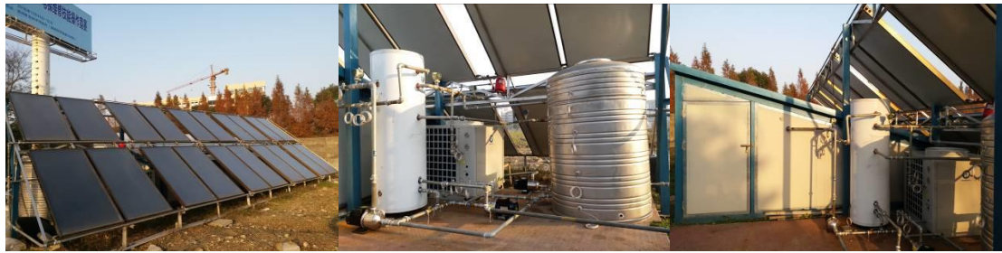
图 2 太阳能热泵装置实景图
