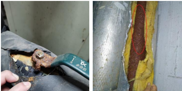
(a) 管道阀门腐蚀 (b) 管道腐蚀
