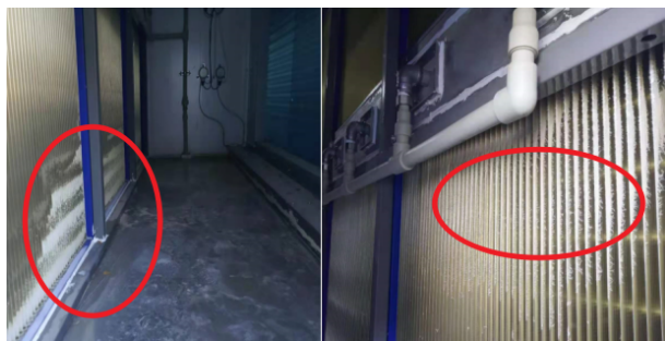
图 3 换热芯体结冰实物图
