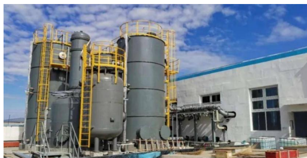
图 4 国家电投铁铬液流电池示范项目 [10]
