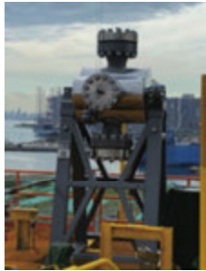
图 8 印刷电路板式换热器在海洋平台上的应用
